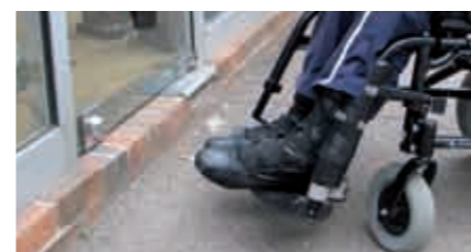
Porte d'accès d'un restaurant inaccessible qui dispose pourtant à l'intérieur de tous les aménagements nécessaires à l'accueil des personnes à mobilité réduite. Les investissements réalisés ne pourront être utilisés sans la suppression de cet obstacle.
